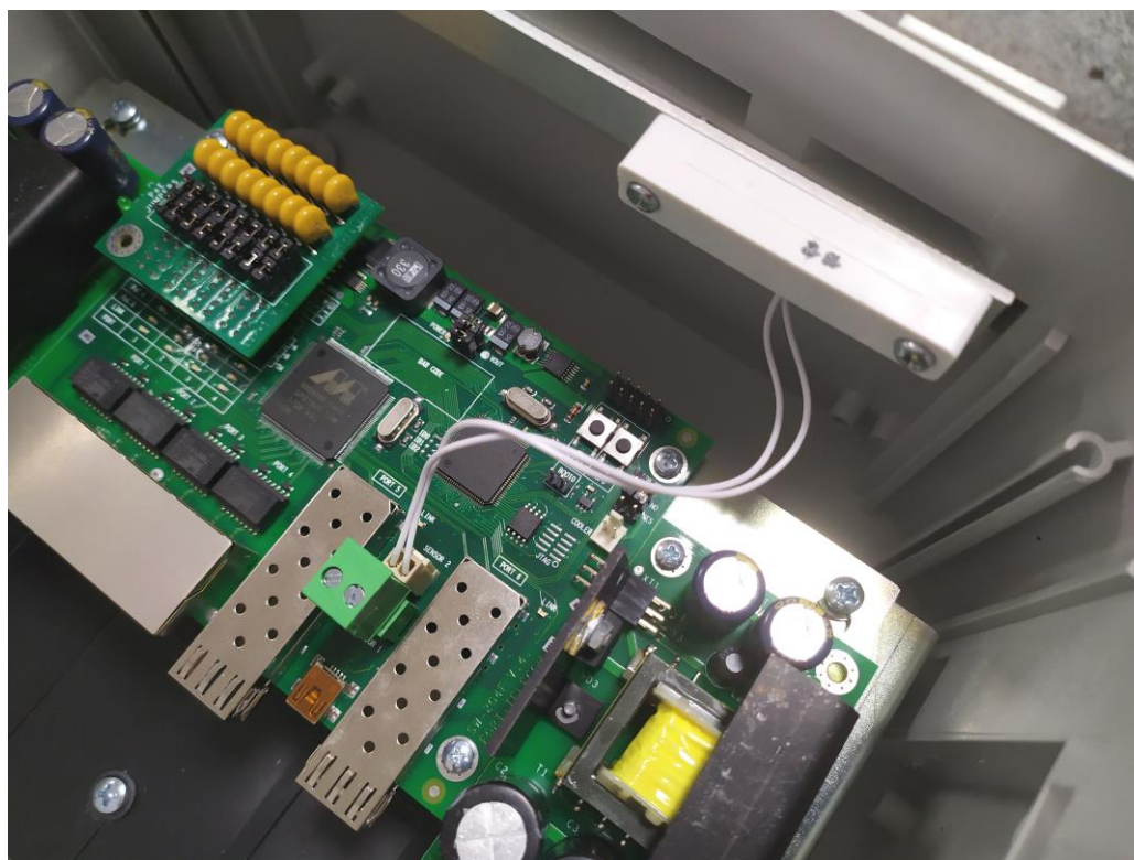
Рисунок 3.6.2 - Датчик вскрытия на корпусе коммутатора
