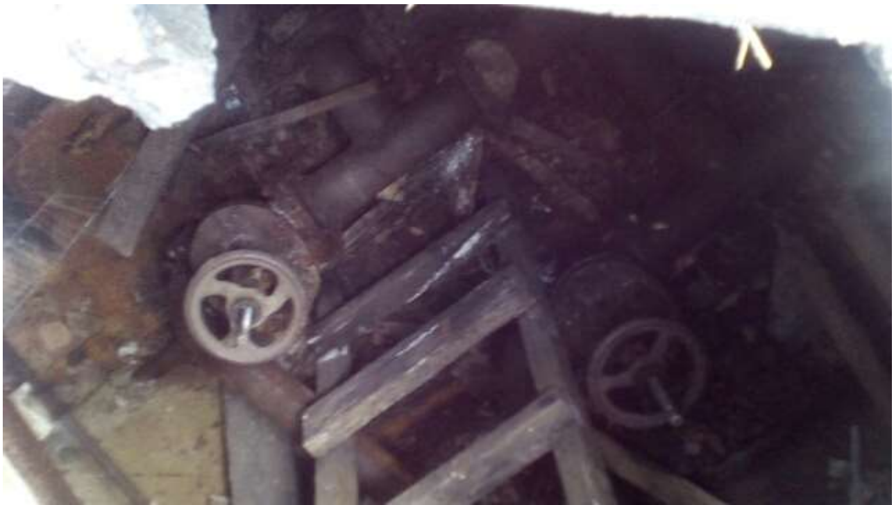
Рис. 3.63 Тепловые сети и тепловые камеры котельной Судоверфи
