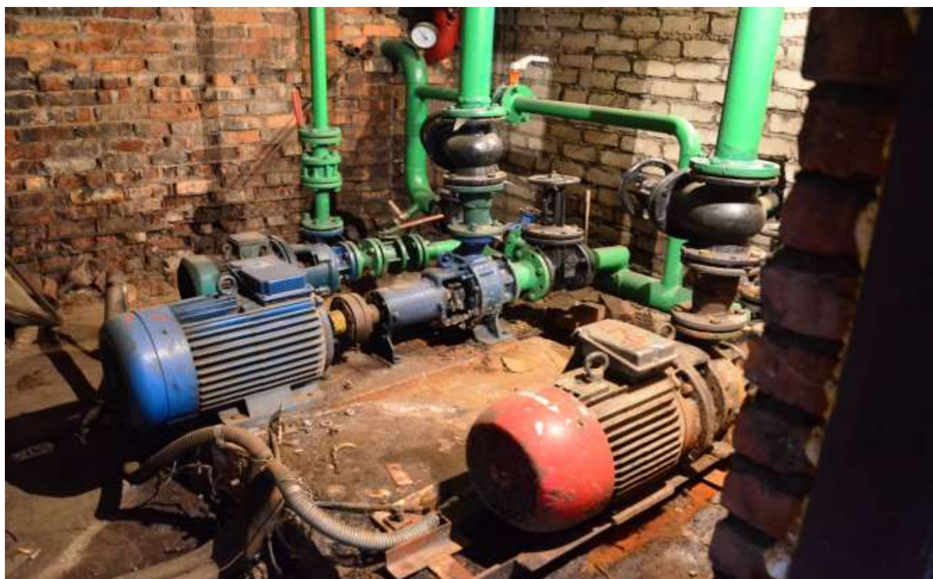
Рис. 3.31 Состояние насосной группы
