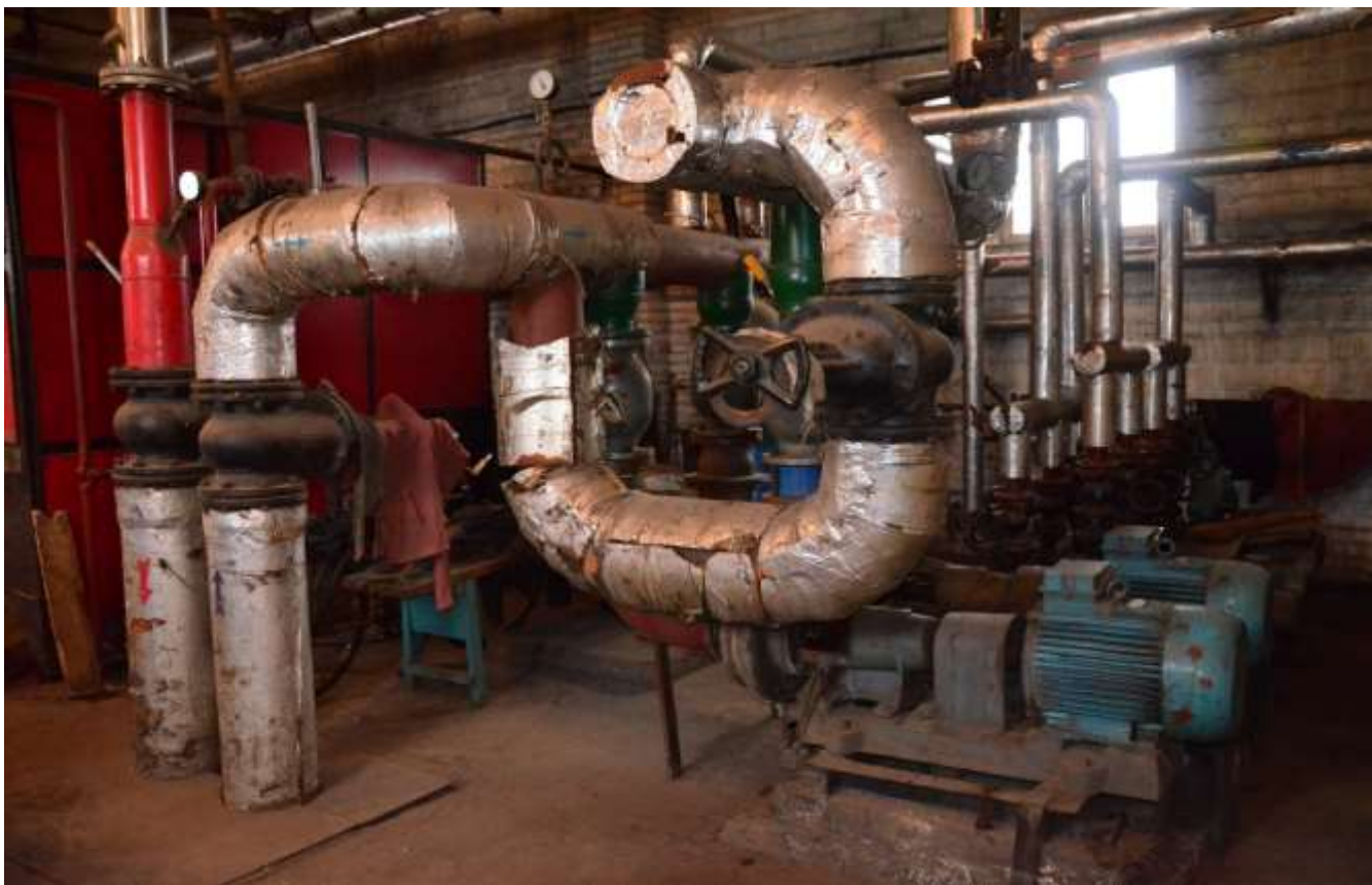
Рис. 3.37 Состояние насосной группы
