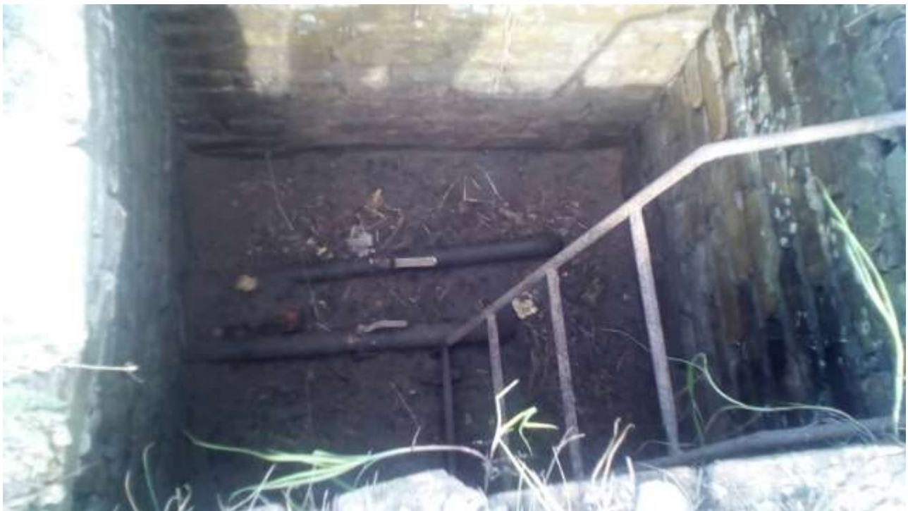
Рис. 3.64 Тепловые сети и тепловые камеры котельной ПМК-2
