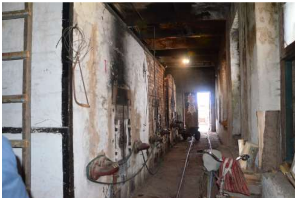
Рис. 3.20. Вид котельной изнутри.
