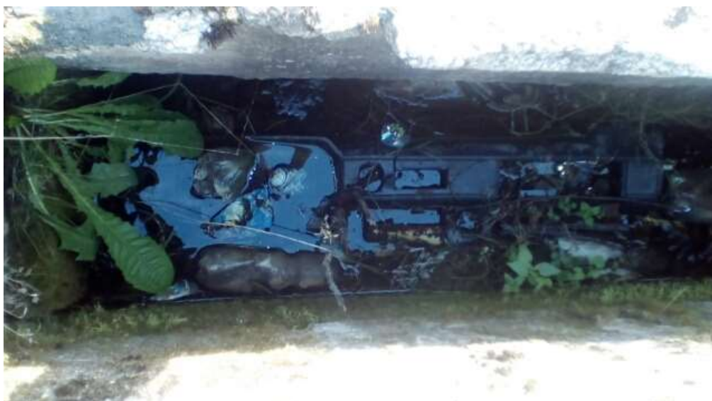
Рис. 3.62 Тепловые сети и тепловые камеры котельной ЛПХ
