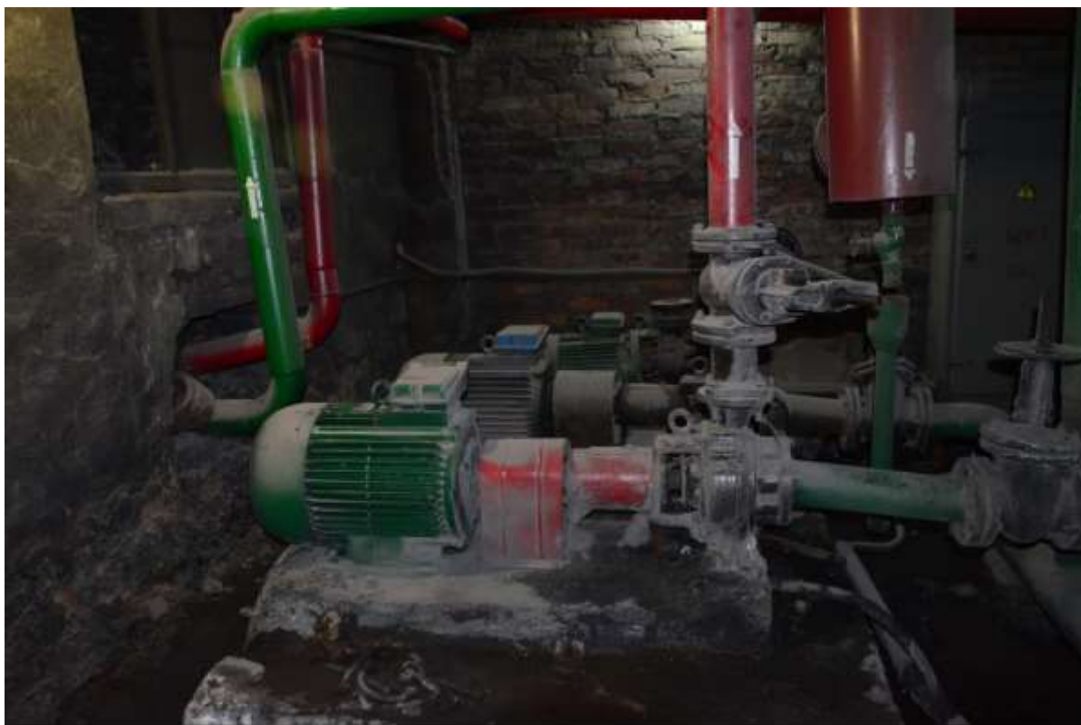
Рис. 3.7. Состояние насосной группы котельной ЦРБ
