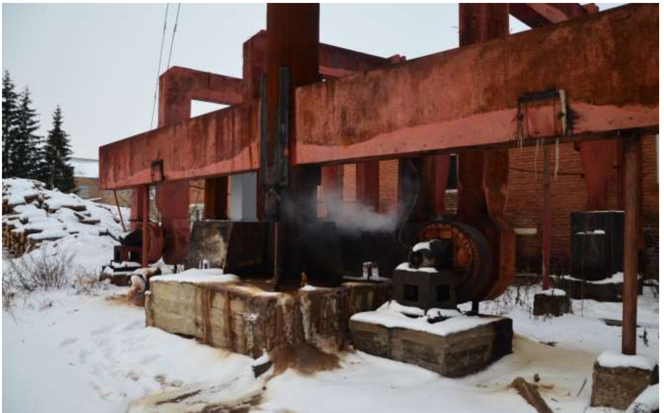
Рис. 3.38 Состояние дымососов 3.8 НАРУЖНЫЙ ОСМОТР КОТЕЛЬНОЙ ПМК 1313
