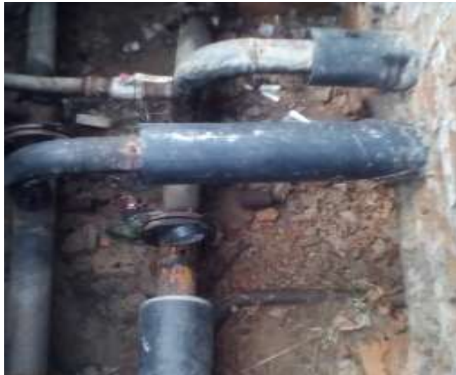
Рис. 3.60 Тепловые сети и тепловые камеры котельной ЦРБ
