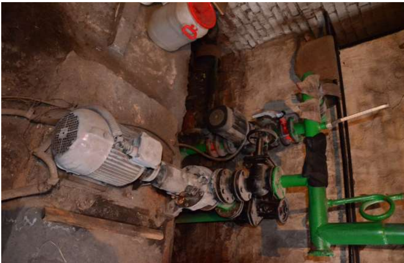
Рис. 3.49 Состояние насосной группы
