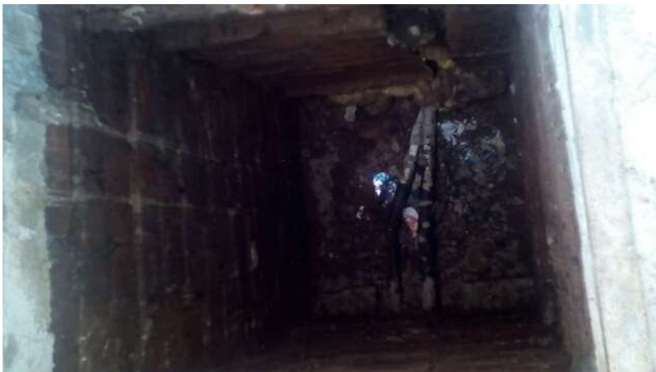
Рис. 3.70 Тепловые сети и тепловые камеры котельной Центральная
