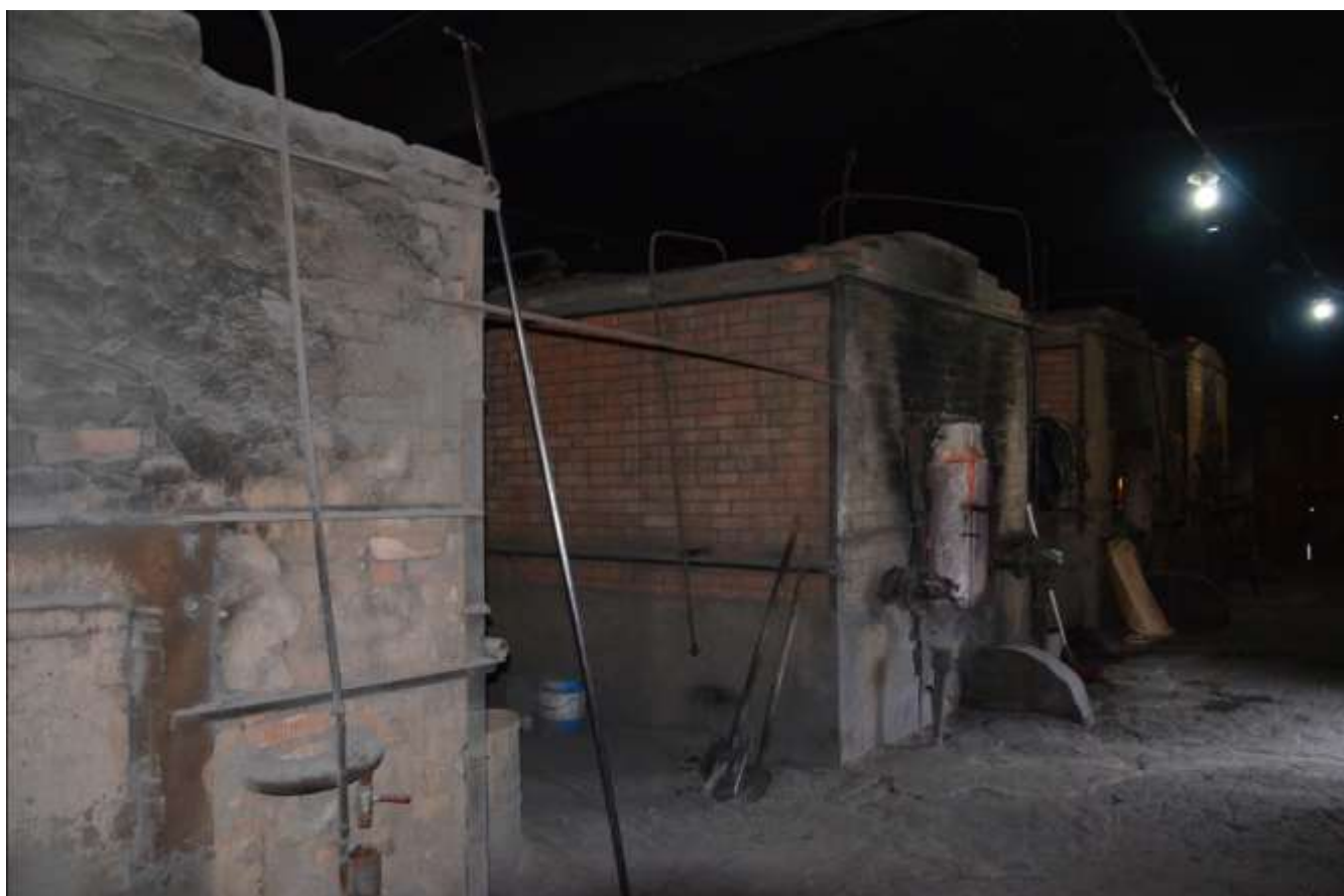
Рис. 3.6. Котлы в котельной ЦРБ
