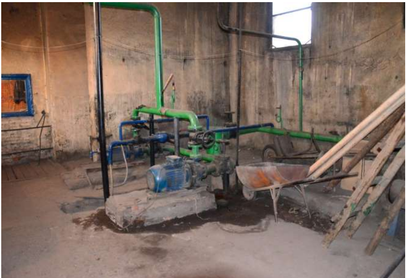
Рис. 3.43 Состояние насосной группы
