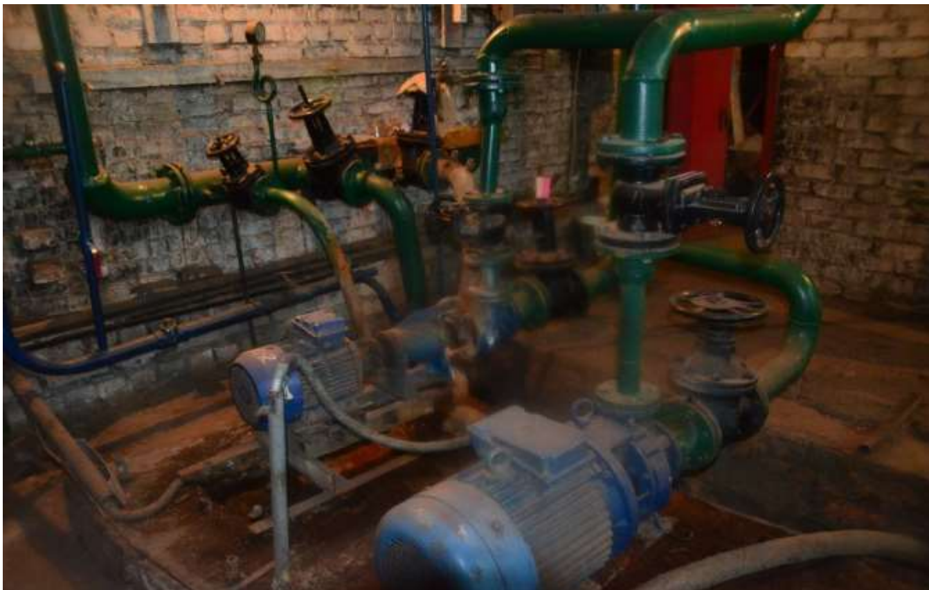
Рис. 3.54 Состояние насосной группы
