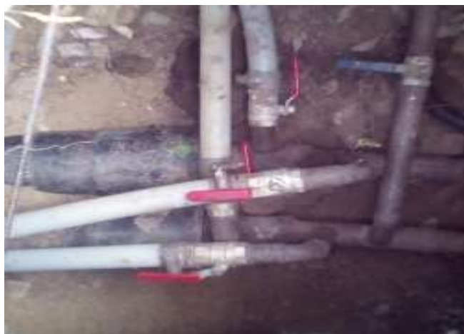
Рис. 3.61 Тепловые сети и тепловые камеры котельной Д/С №5
