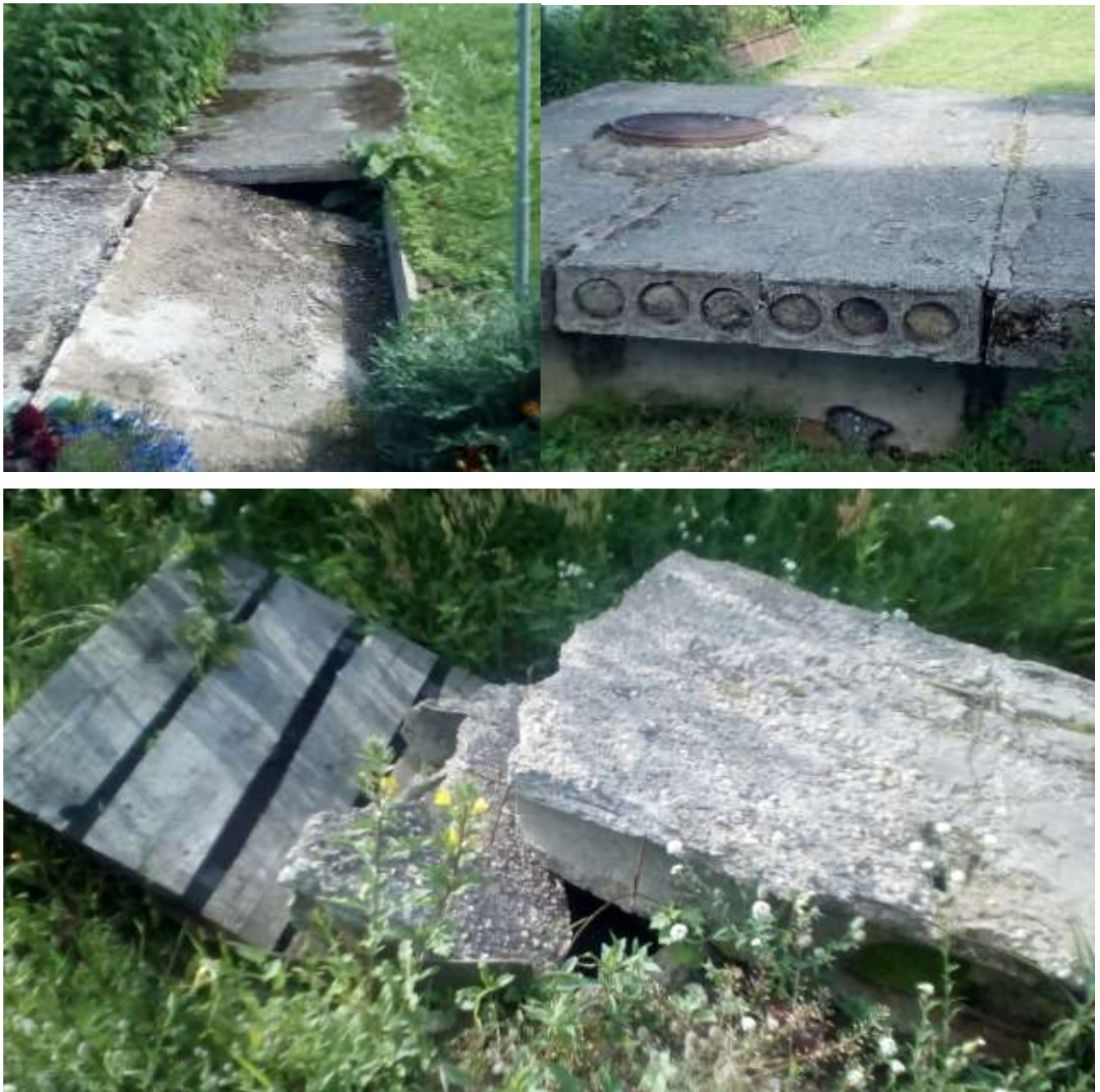
Рис. 3.65 Тепловые сети и тепловые камеры котельной ДСПМК
