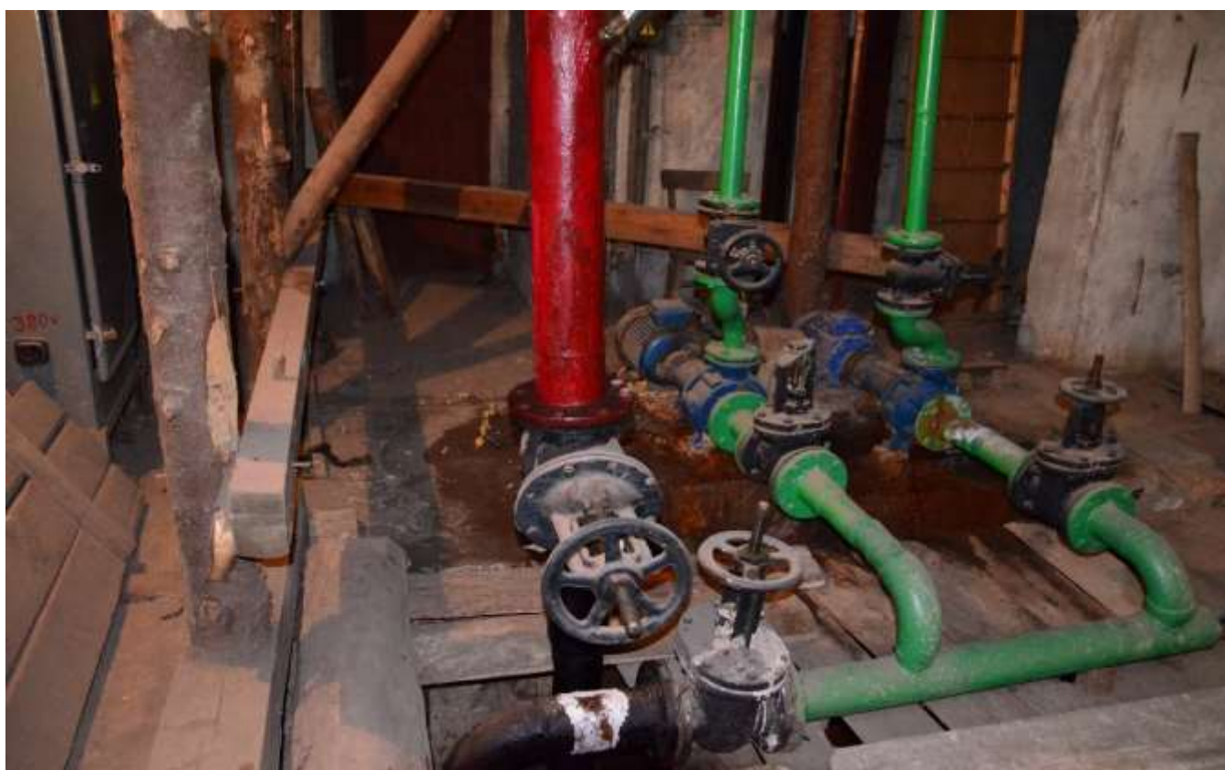
Рис. 3.59 Состояние насосной группы
