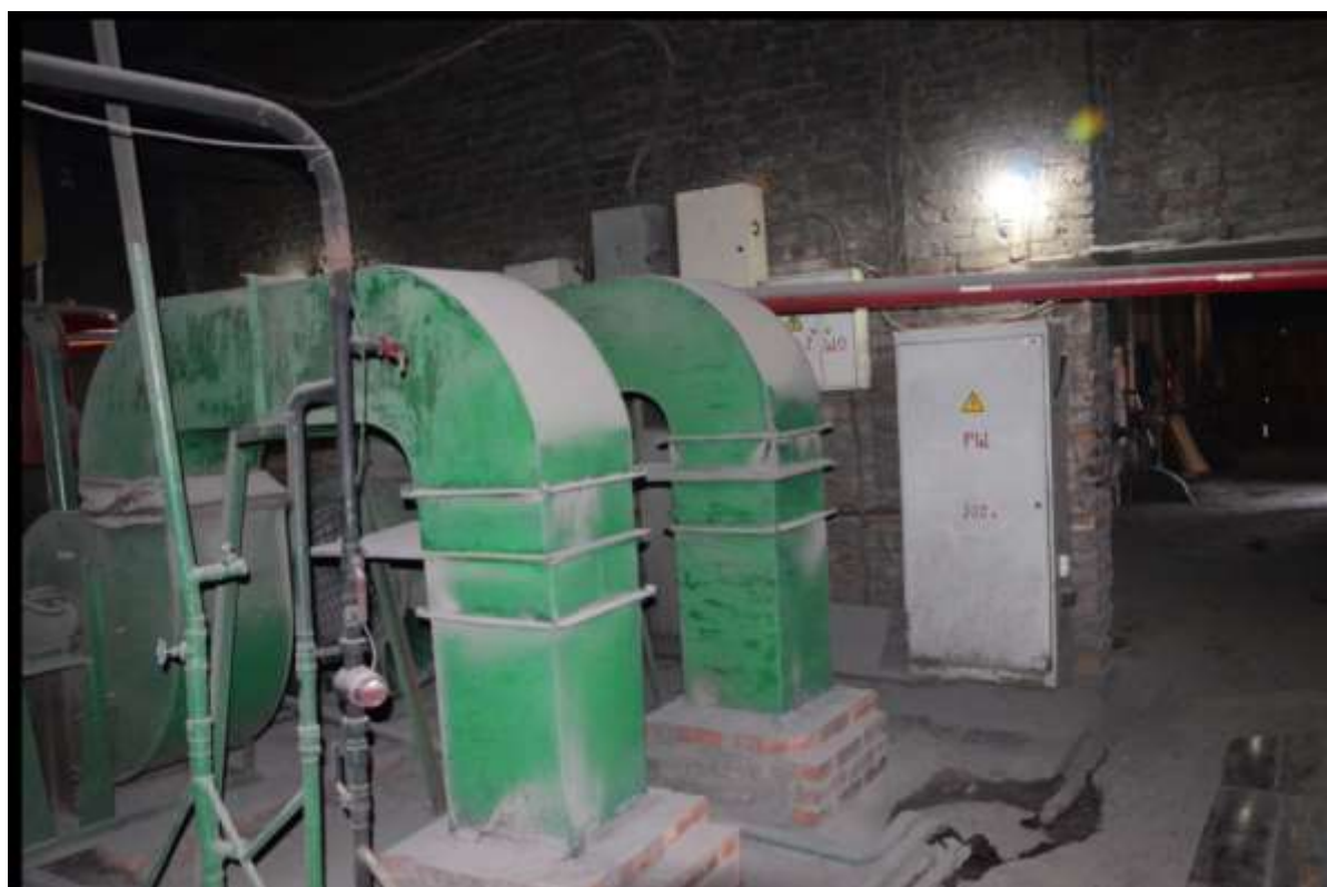
Рис. 3.8. Вентиляторы поддува котельной ЦРБ
